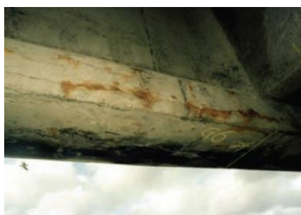
海岸沿いに立てられた PC 橋の劣化状況
